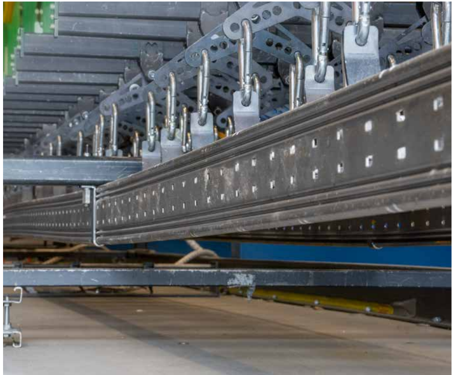
Produkter som testats enligt standarden gör det möjligt för kunden att jämföra system med varandra. Bilden ovan visar kabelstegen som testas för säker arbetsbelastning med den kalibrerade testanordningen i Meka Pro's testlaboratorium.
